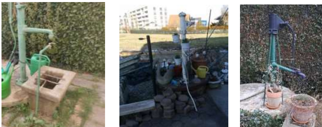
Slike 44, 45, 46: Litoželezne črpalke na Iztokovi, Studenški in Padežnikovi ulici (Vir: lastne fotografije)
